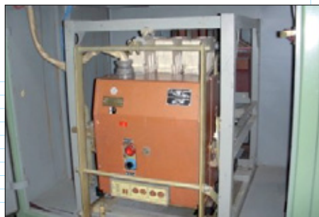
Рис. 2. Ячейка с выключателем до замены
