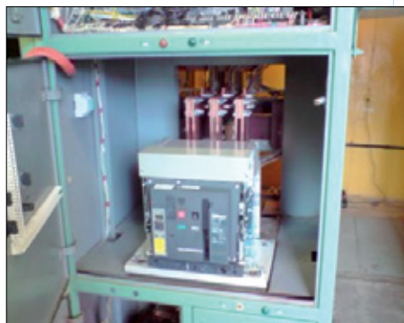
Рис. 3. Ячейка с новым автоматическим выключателем MasterPact NW25 (Schneider Electric)
